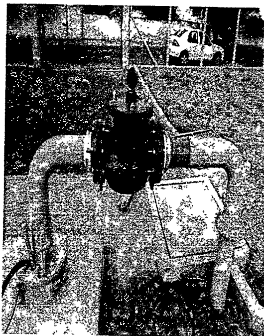
Poço e medidor de vazão Zanata.
